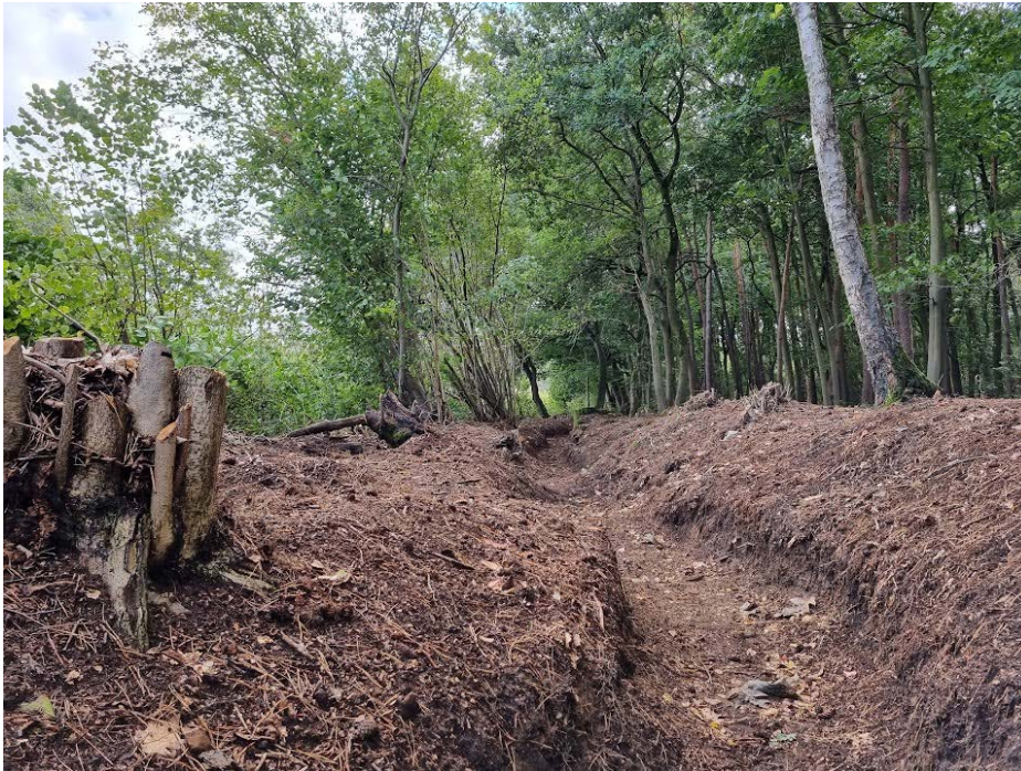
Advies en begeleiding bij uitvoeren terreinwerken vrijmaken loopgraafrelict Kwezelstraat ter voorbereiding van uitvoering WOII-project
